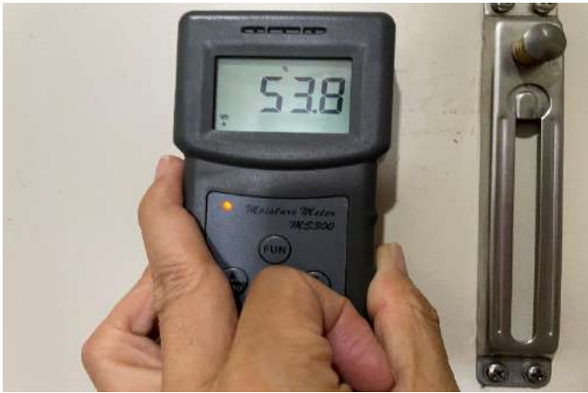
▲表面乾燥 鋼製両面フラッシュ片開き扉 SOP 塗 53.8%
